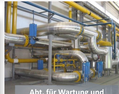
Abt. für Wartung und Service von kryogenischen Anlagen
